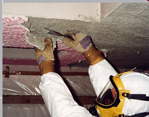
BONIFICA AMIANTO FRIABILE
